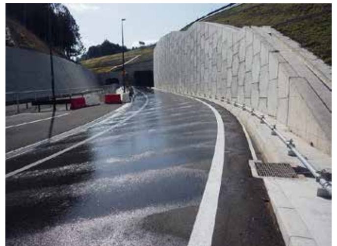
日高北 I C オフランプの散水状況
