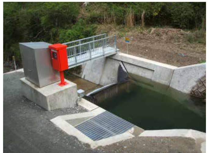
河川水取水ゴム堰施設
